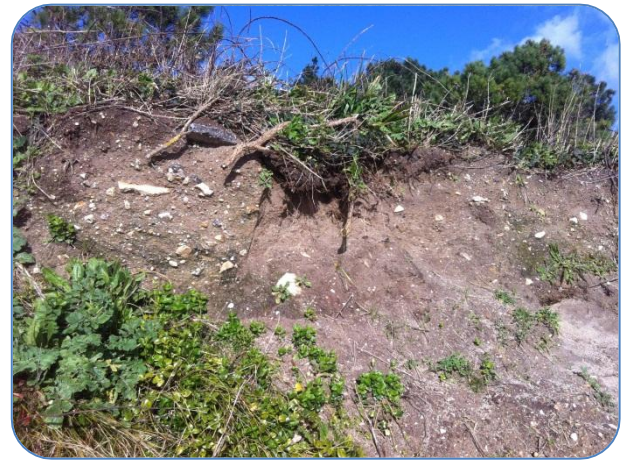
Figure 16 Les remblais effectués sur la dune en 1996 (zone dunaire Ouest).
